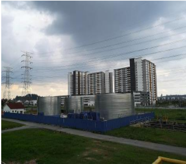
RSTP Setia Alam 1 WRP – 4 MLD
